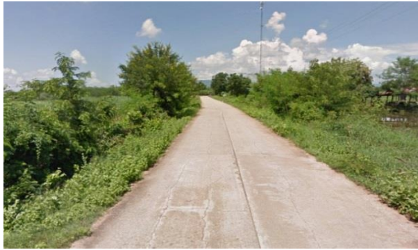
ภาพประกอบที่ ๑๒ ถนนท้องถิ่น ชย. ๔๒๔๖ (บ้านโนนเช่า - บ้านกุดหัวช้าง)
